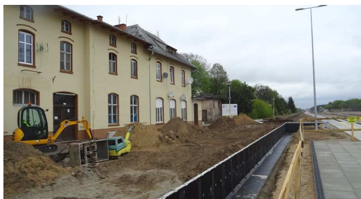
8. Prace modernizacyjne na stacji kolejowej, widok w kierunku wschodnim, (fot. Zb. Januszaniec, kwiecień 2019 r.)
