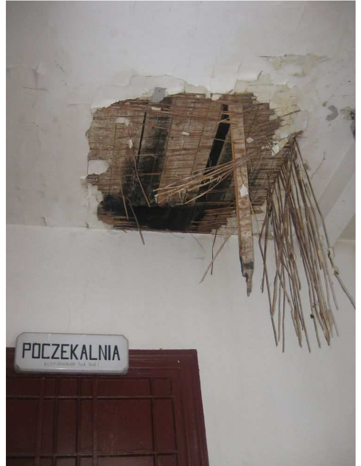
4. Dworcowy sufit zniszczony przez pożar, (fot. Zb. Januszaniec, styczeń 2014 r.)
