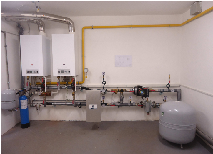
Kotłownia gazowa budynek Wałęcka 54 Przychodnia Zdrowia
