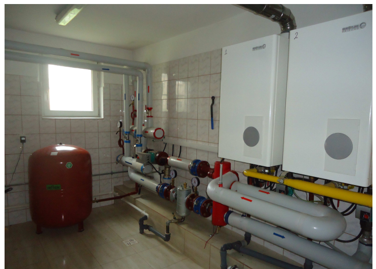
Kotłownia gazowa Wspólnota mieszkaniowa Sikorskiego 22
