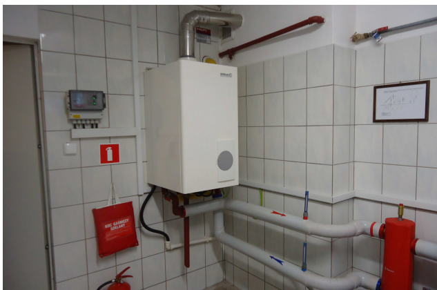
Kotłownia gazowa Wspólnota mieszkaniowa ul. Sikorskiego 45.
