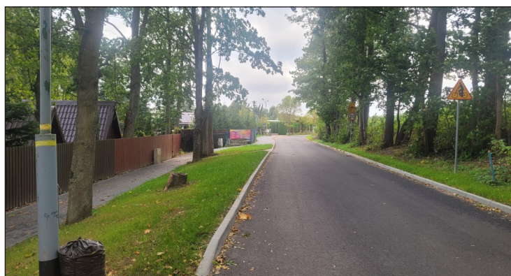
Budowa dróg gminnych w północnej części miasta Czarnie w ulicach Pięciu Pomostów, Jarzębinowej i Jesionowej
