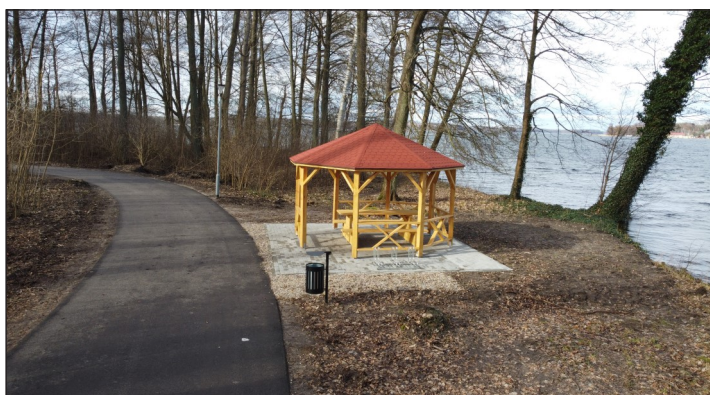
Budowa ścieżki pieszo-rowerowej w Czarnie – odcinek od ul. Parkowej do ul. Nadbrzeże Drawskie
