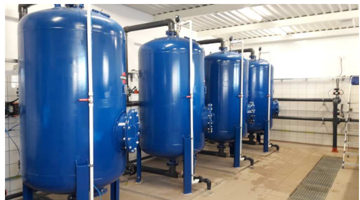
Nowe filtry ciśnieniowe w budynku stacji wodociągowej w Starym Drawsku
