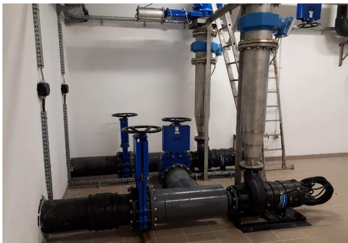
Instalacja technologiczna w budynku MBR
