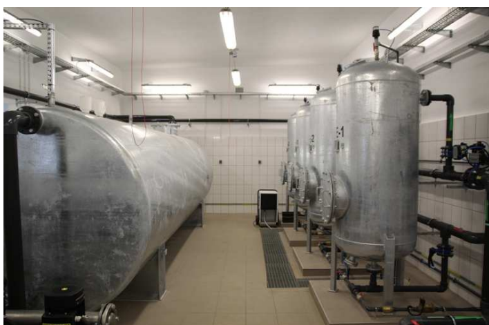
Nowe urządzenia technologiczne w budynku stacji
