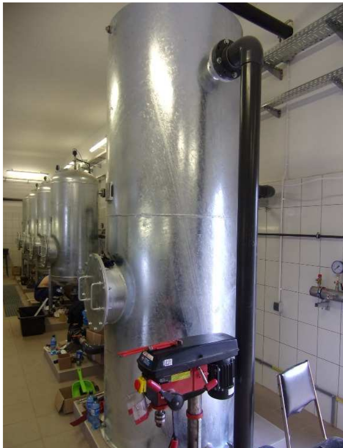
Nowe urządzenia technologiczne w budynku stacji
