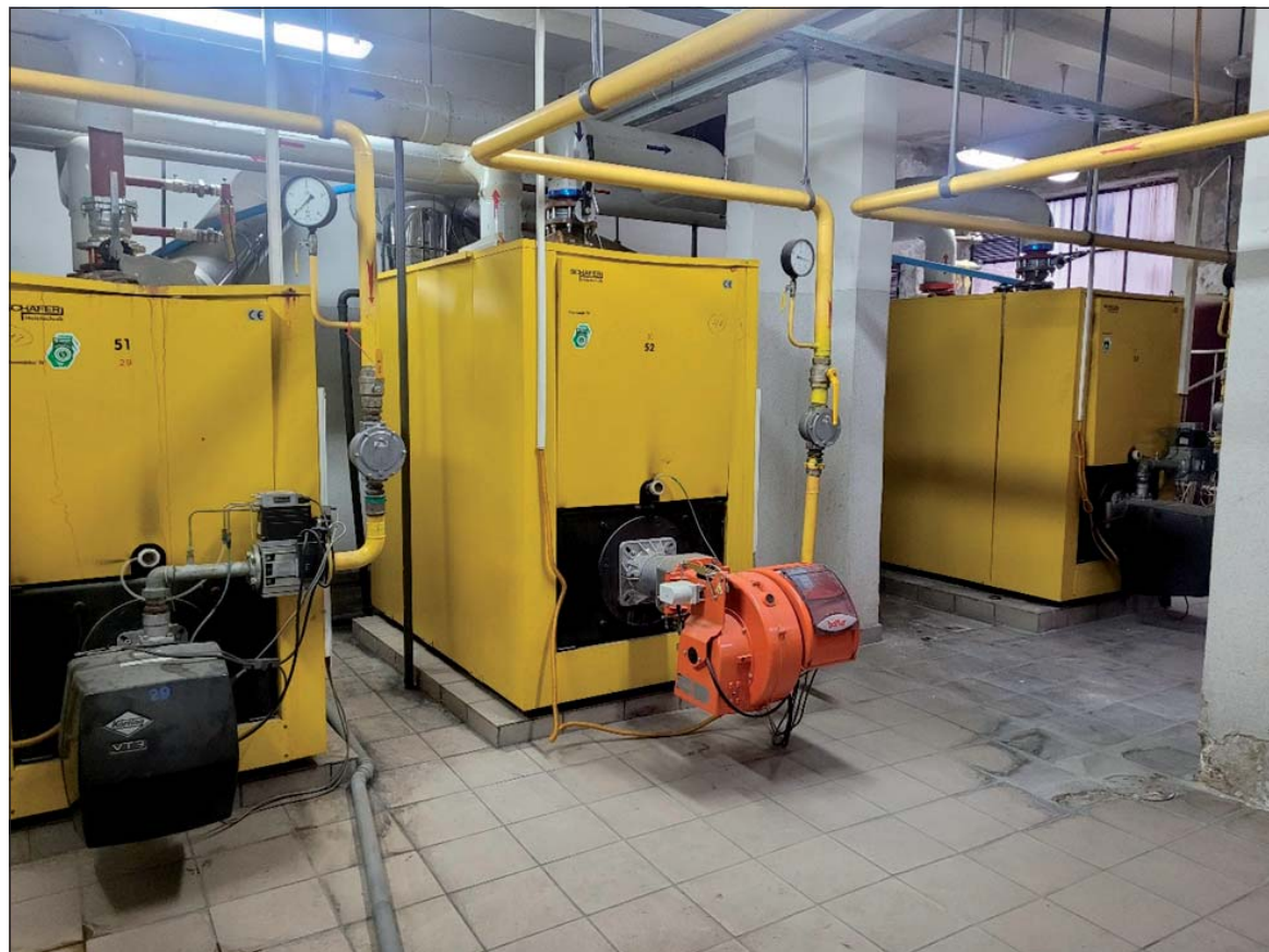
Obecna kotłownia w budynku Szkoły Podstawowej
