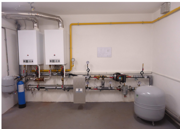
Kotłownia gazowa budynek Wałęcka 54 Przychodnia Zdrowia
